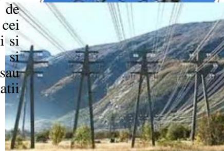
Linie de inalta tensiune
